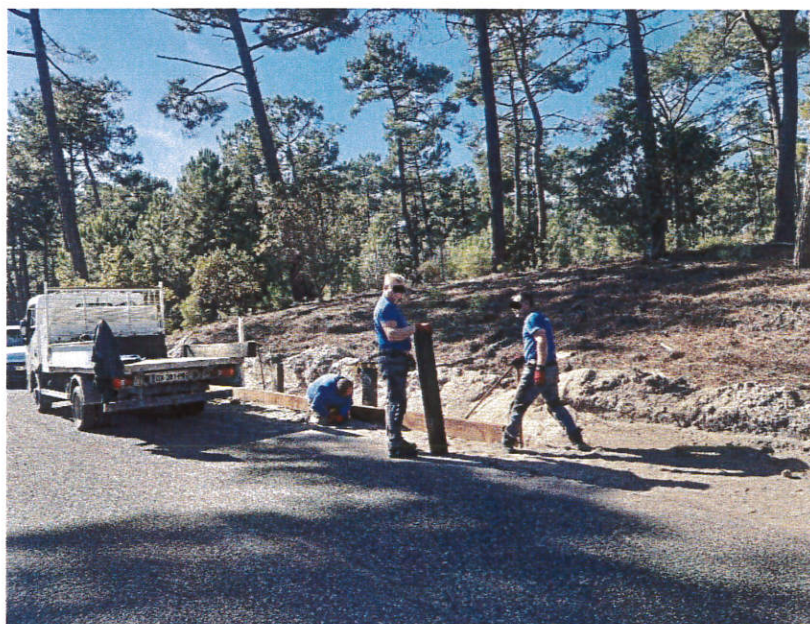
LA JENNY : Confection par nos équipes des retenues de sable avec des poutres en chêne
